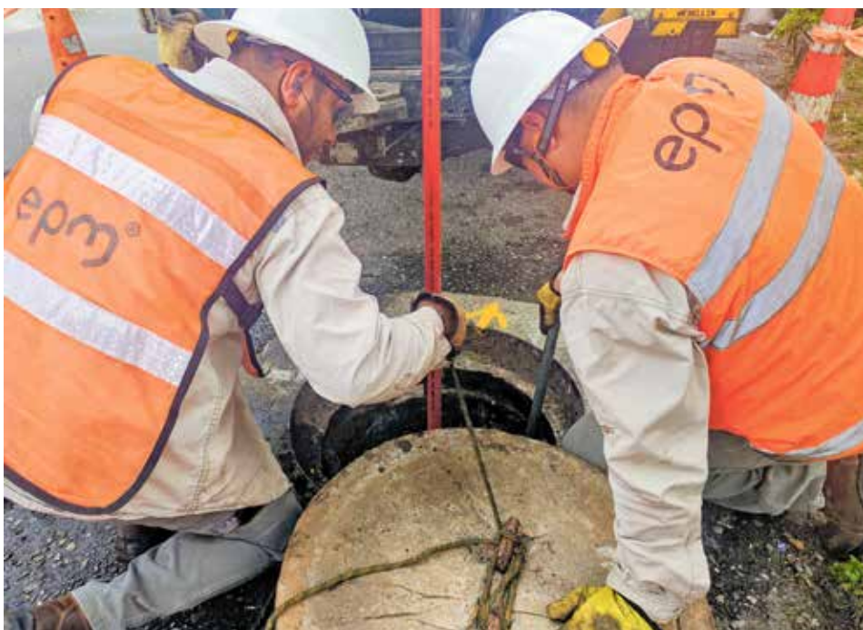
Cuidar el alcantarillado es un trabajo compartido: mientras EPM inspecciona y mantiene la red, desde casa podemos evitar arrojar residuos que la obstruyan.
