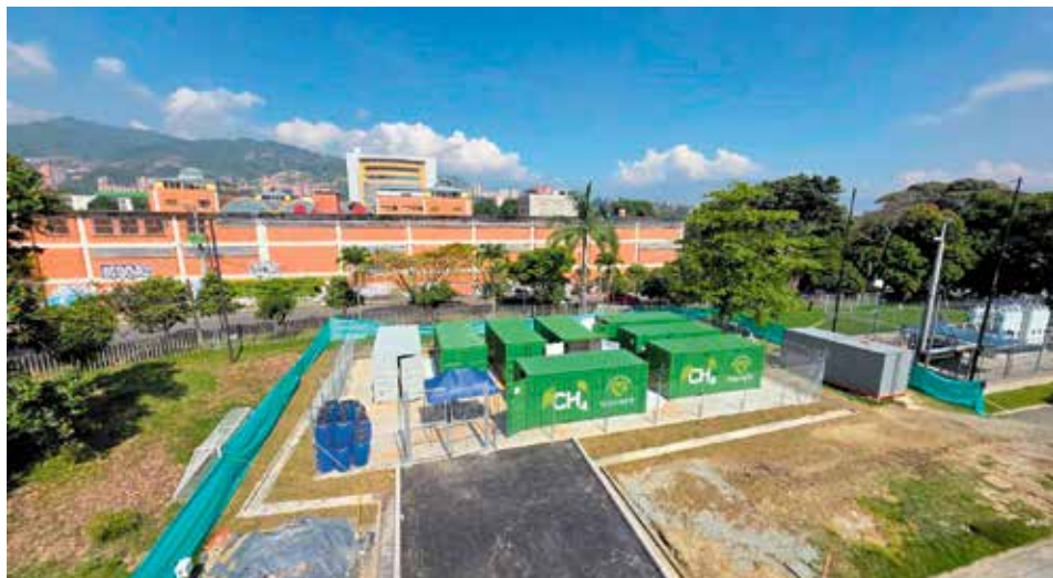
Proyecto de biodigestión en la planta de tratamiento de Aguas Residuales San Fernando.
