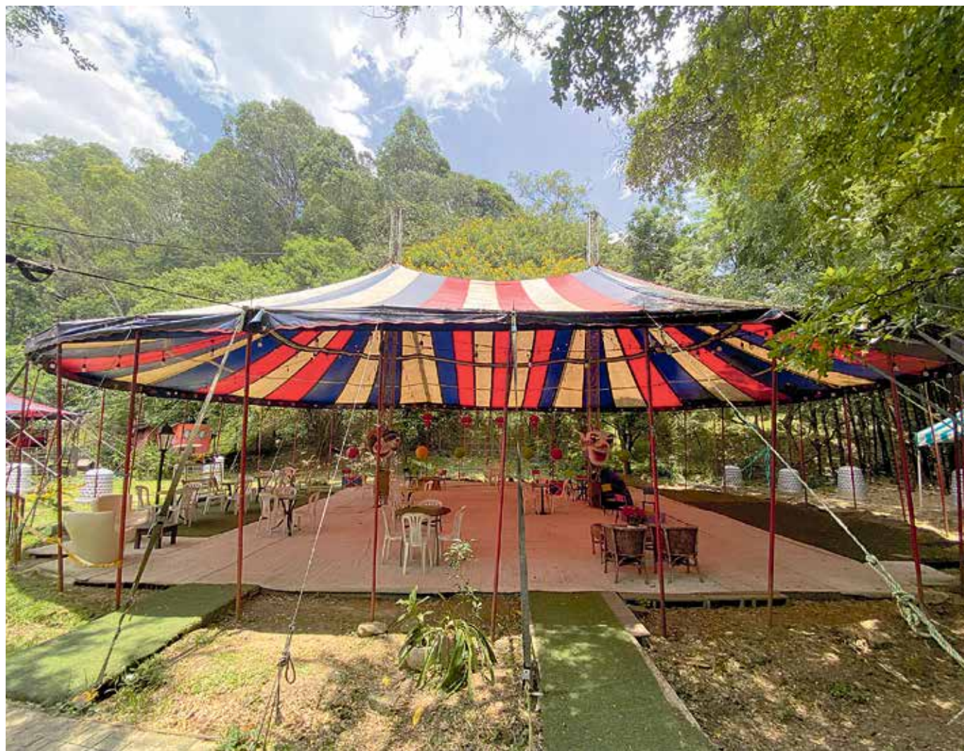
Esta es una de las carpas que conforman el Circo de Medellín y que presenta daños en su estructura. Habitualmente, las personas esperan allí antes de pasar al escenario.
