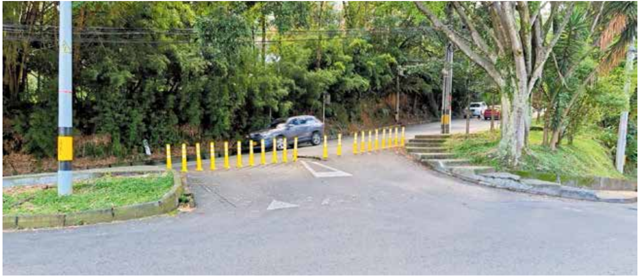
Independiente del futuro intercambio en el sector de Linares – El Tesoro, la Secretaría de Movilidad acaba de instalar estos elementos para eliminar uno de los puntos de conflicto vial en este sector. La proyectada obra, que arrancará a finales de este año, entregará una solución definitiva que, además, promete mejorar la fluidez vehicular y los tiempos de viaje.
