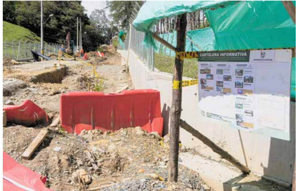
Las antiguas cunetas en concreto que tenía esta vía, antes de que se iniciaran los malogrados trabajos de ampliación, fueron retiradas y no han sido reemplazadas, afectando la condición general del terreno.
