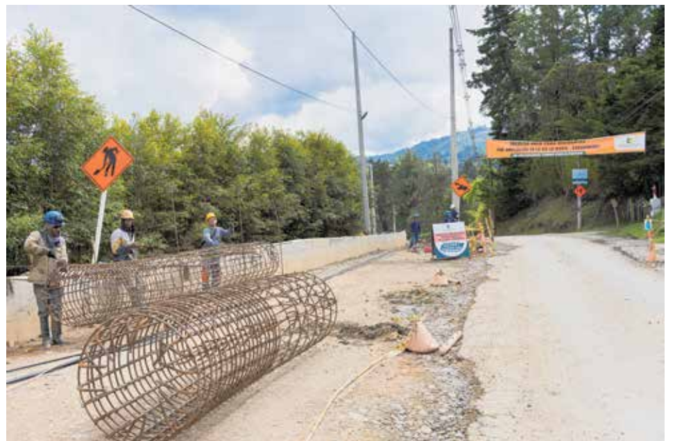
Obreros arman las canastas de hierro para la estructura de futuros pilotes. En la imagen, también se puede apreciar la nueva secuencia de postes, junto a la antigua; ambas están a la espera de la rectificación de las líneas eléctricas, que debe darse en un futuro por definir.
