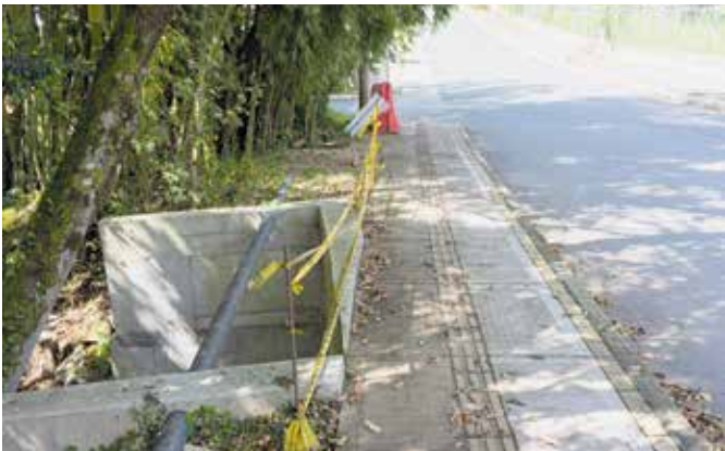
Aspecto de uno de los pocos tramos de andenes nuevos. Pese a que la acera cuenta con línea podotáctil para invidentes, pasa junto a un box culvert que carece peligrosamente de barandales.
