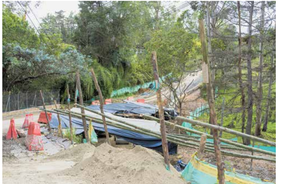
Las lluvias y los afluentes que atraviesan la zona ralentizan las obras. A la falta casi general de cunetas, se suma el hecho de que varios sumideros proyectados, necesarios para evacuar las aguas, no se han terminado o no son operativos.
