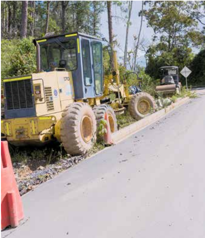
Remanentes de la maquinaria utilizada por el primer contratista, la cual se está oxidando a la intemperie, desde septiembre de 2023, cuando el constructor inicial abandonó la obra.
