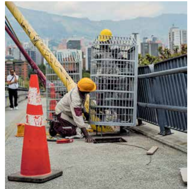
Mientras recorríamos la estructura, Vivir en El Poblado constató que EPM ya inició con la renovación de la iluminación arquitectónica en el puente de la 4 Sur.
