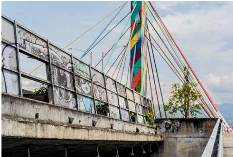
El deterioro por efecto de vandalismo es evidente en muchos sectores del puente de la 4 Sur. Hasta ahora van 207 paneles dañados.
