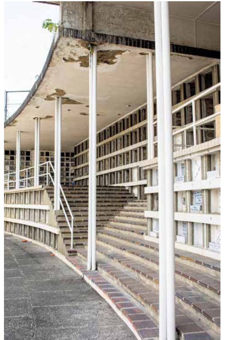
La actual distribución espacial dentro de este cementerio centenario data de la década de 1960. El predio aprueba las revisiones periódicas que le hace la secretaría de Salud de Medellín; la última de ellas fue en agosto de 2023. Las principales observaciones: humedades y empozamientos.
